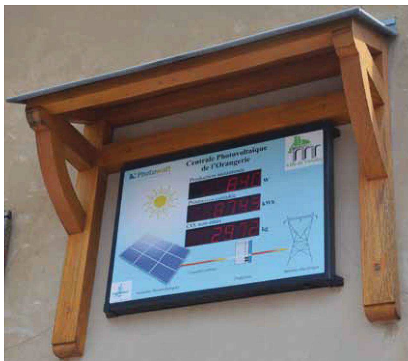
« Vers la transition énergétique » (Panneau de contrôle d'une installation photovoltaïque individuelle).
